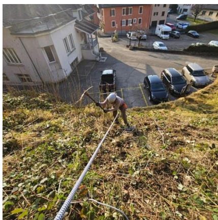
Une petite équipe de professionnels utilise des pioches pour lutter contre les ailantes en ville de Bex à la fin de l'année (projet 4.1)
